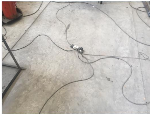
Imagen 39. Cables en el piso
