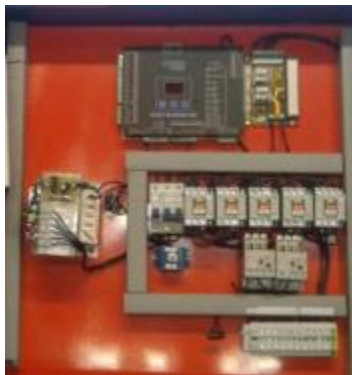
Imagen 17. Tablero de Control
