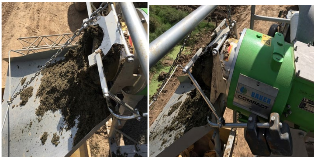
Foto 20 Máquina separadora de Sólidos trabajando.
