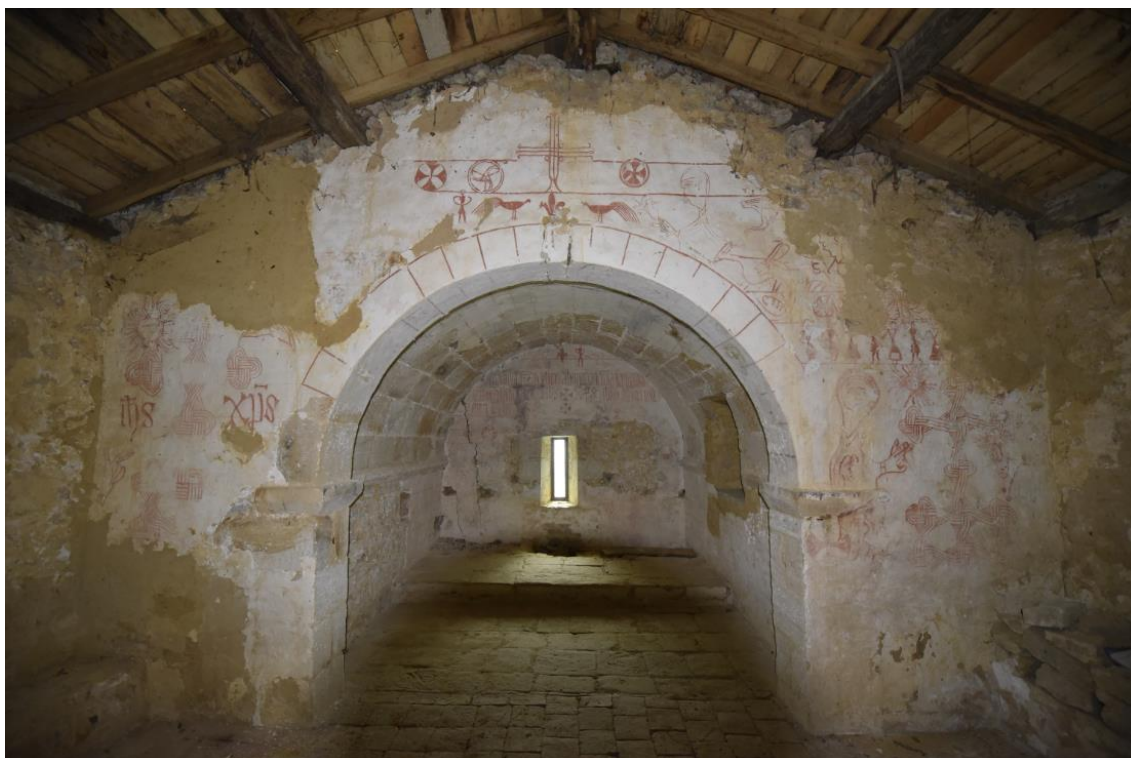
Arco de gloria en 2015, con sorprendentes pinturas en sus hombros, antes de la intervención
